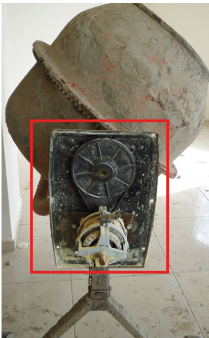
Figura 45. Mecanismul neprotejat al unui malaxor de beton.
